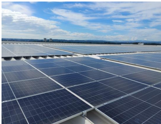
太陽電池モジュール
